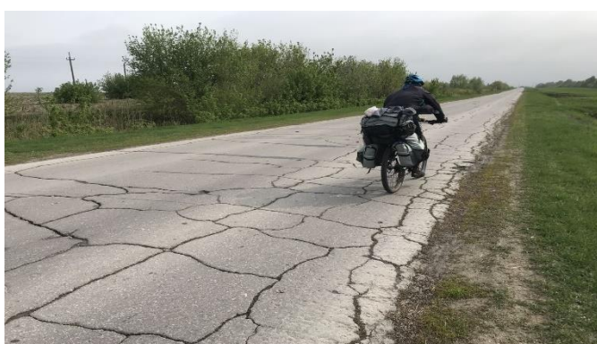
9.Асфальт после Левашовки 2 (трещины)
