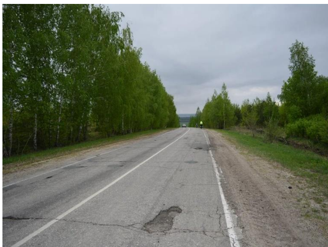
5. Асфалт с трещинами (шоссе)
