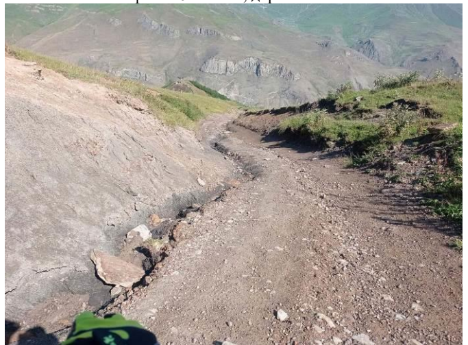
фото 48 Грунт, дорога разбитая, сух.
