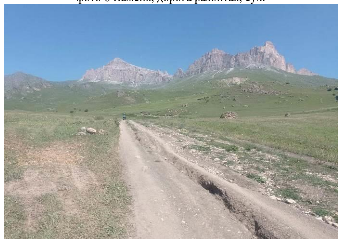
фото 8 Грунт, дорога разбитая, сух.
